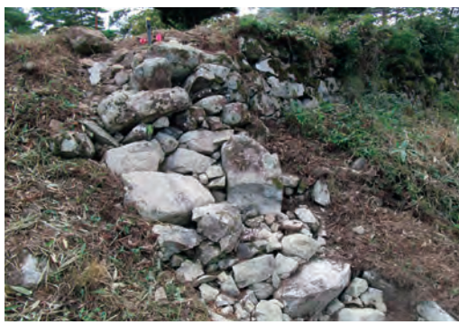
崩れた石垣②
