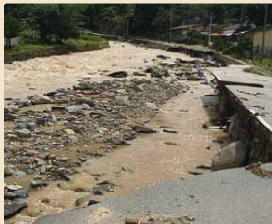
被災した道路(朝日町)
