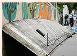
倒壊したブロック塀
