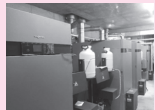
桜香の湯(チップボイラー)
