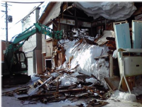
豪雪による建物の倒壊
