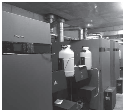
地下室に設置された木質チップボイラー
