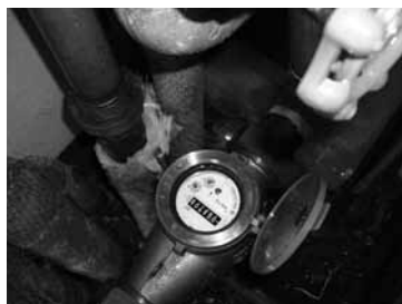
地下漏水の現地視察
