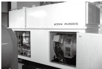
本庁の自家発電装置
