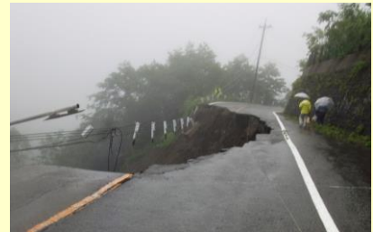
乗鞍スカイライン被災状況
