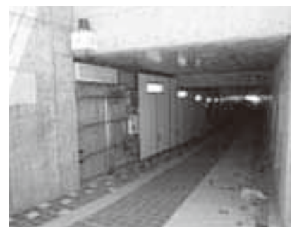
出入口の赤色灯と壁面の防犯スイッチ
