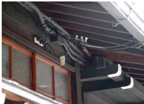
軒下の死角に、同色の電線が配線されている
