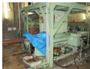
▲汚水を流すためのポンプ
