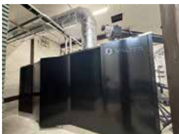
▲木質バイオマス熱電併給設備
