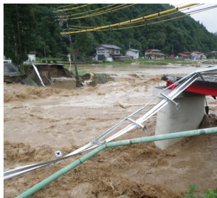
▲平成26年8月豪雨災害(清見町 河渡橋)
