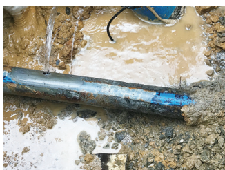
穴が開いて漏水した配水管
