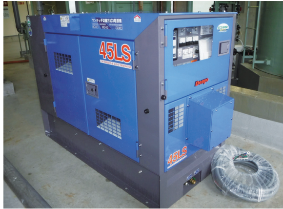
非常用発電機の設定
