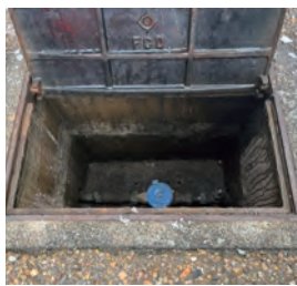
▲水道メーターボックス
