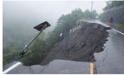
被災現場（復旧前）
