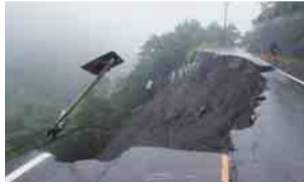
被災現場（復旧前）
