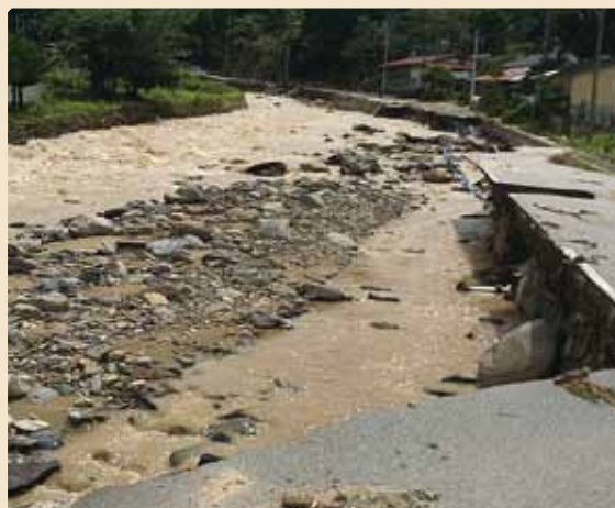
被災した道路（朝日町）
