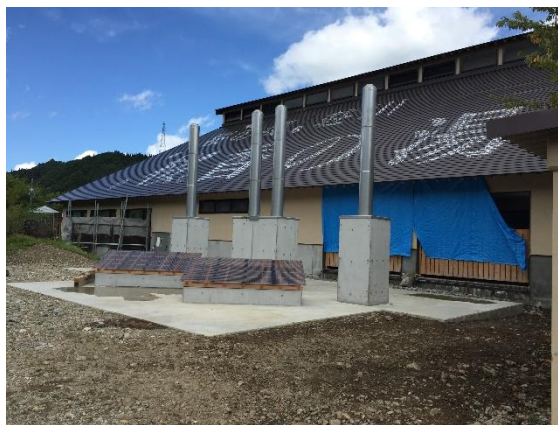
ボイラー施設の建屋外観。手前の 2 つの片屋根はチップ挿入口。奥はボイラーの煙突
