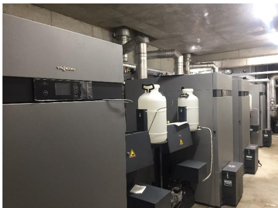
地下室に設置されたボイラー
