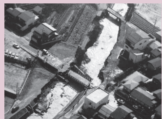
損壊した岡本橋周辺と川岸が崩れた苔川
