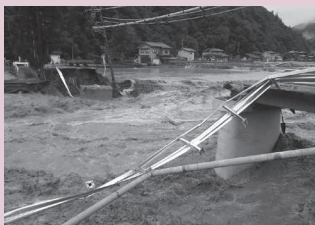
崩壊した清見町の河渡橋
