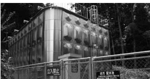
丹生川簡易水道坊方配水池
