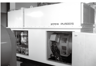
本庁の自家発電装置
