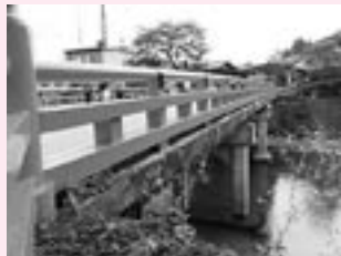
補強が必要な橋りょう
