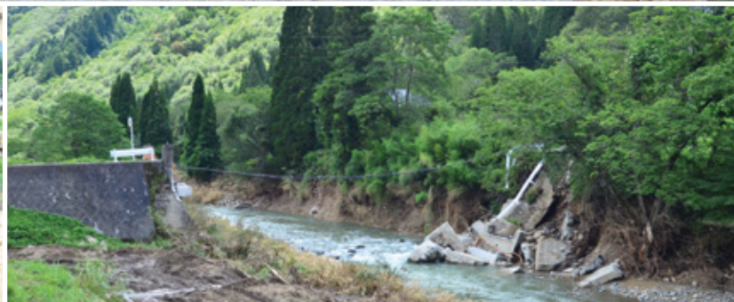
大雨による増水で崩壊した宮前橋
