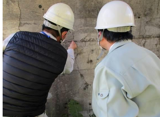
【 立会状況 橋脚の損傷状況－２ 】
