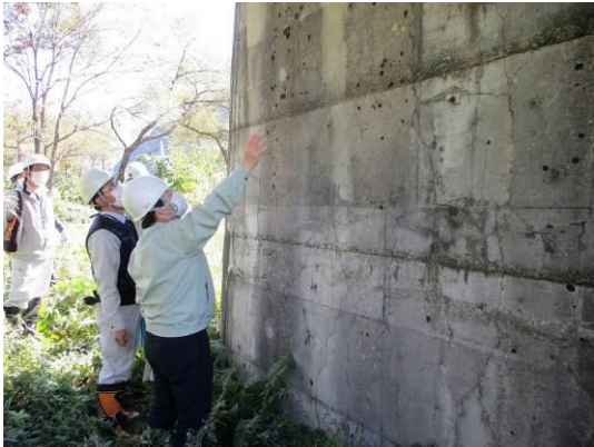
【 立会状況 橋脚の損傷状況－１ 】
