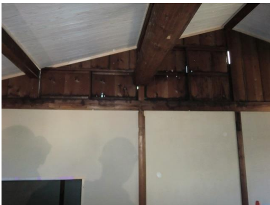
主屋（小屋裏外壁雨漏り部補修必要）
