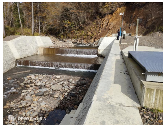
野麦小水力発電所 取水部
