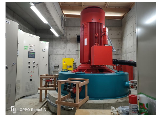
野麦小水力発電所 水車・発電機
