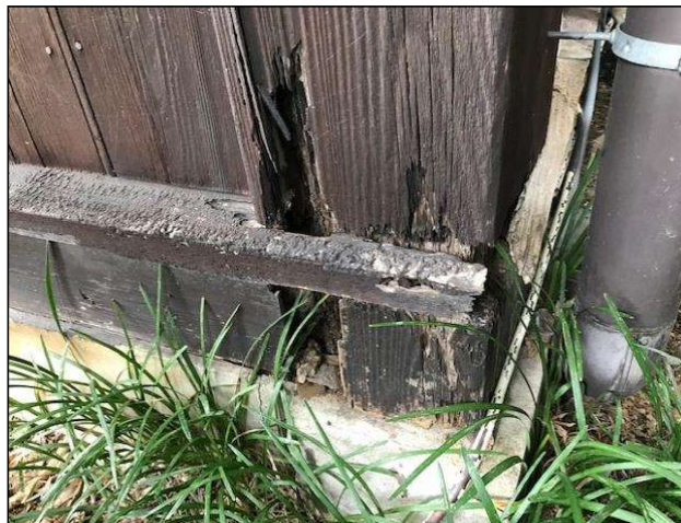
シロアリ被害状況
